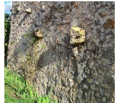
Figure 158 : Pierres dépassant du pignon, TP
