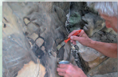
Dégradation d'un abri orné par le feu avec éclatement de la roche. Application d'un ciment de consolidation liquide et incolore et tentative de recollement.
